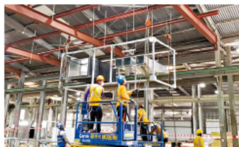
MEP為電氣和管道系統的預製組件。
